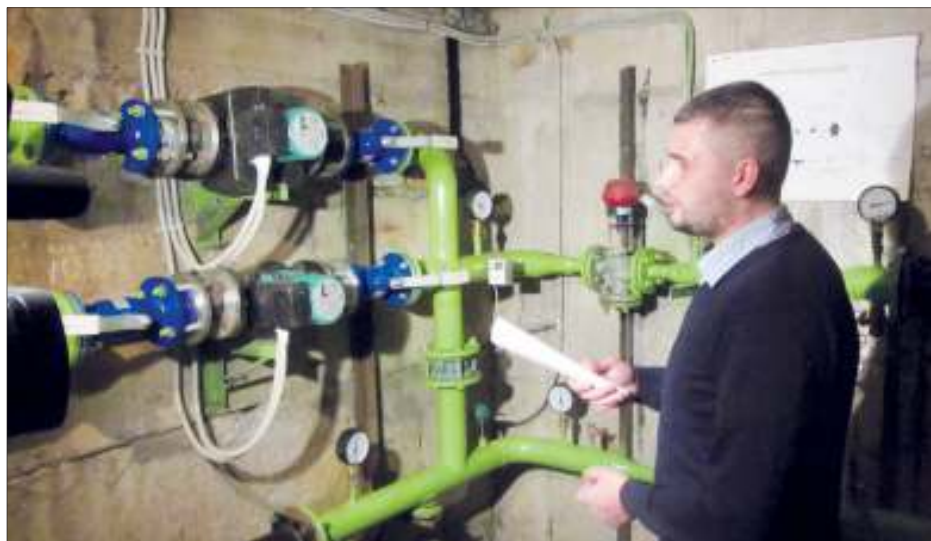
Директор подрядной организации Александр РЯБОВ показал оборудование, установленное в подвале МКД, которое помогает жильцам экономить до 30-40% на оплате за отопление
