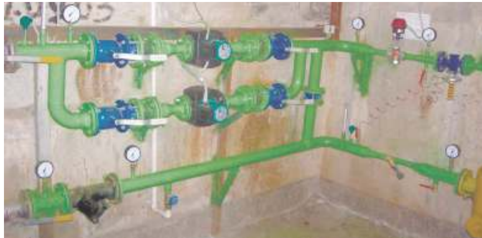
Так выглядит прибор погодного регулирования в подвале дома №32 по ул. Промышленной
