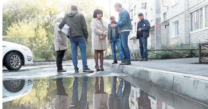
Огромная лужа, которая здесь и до ремонта была, - это не похоже на двор мечты
