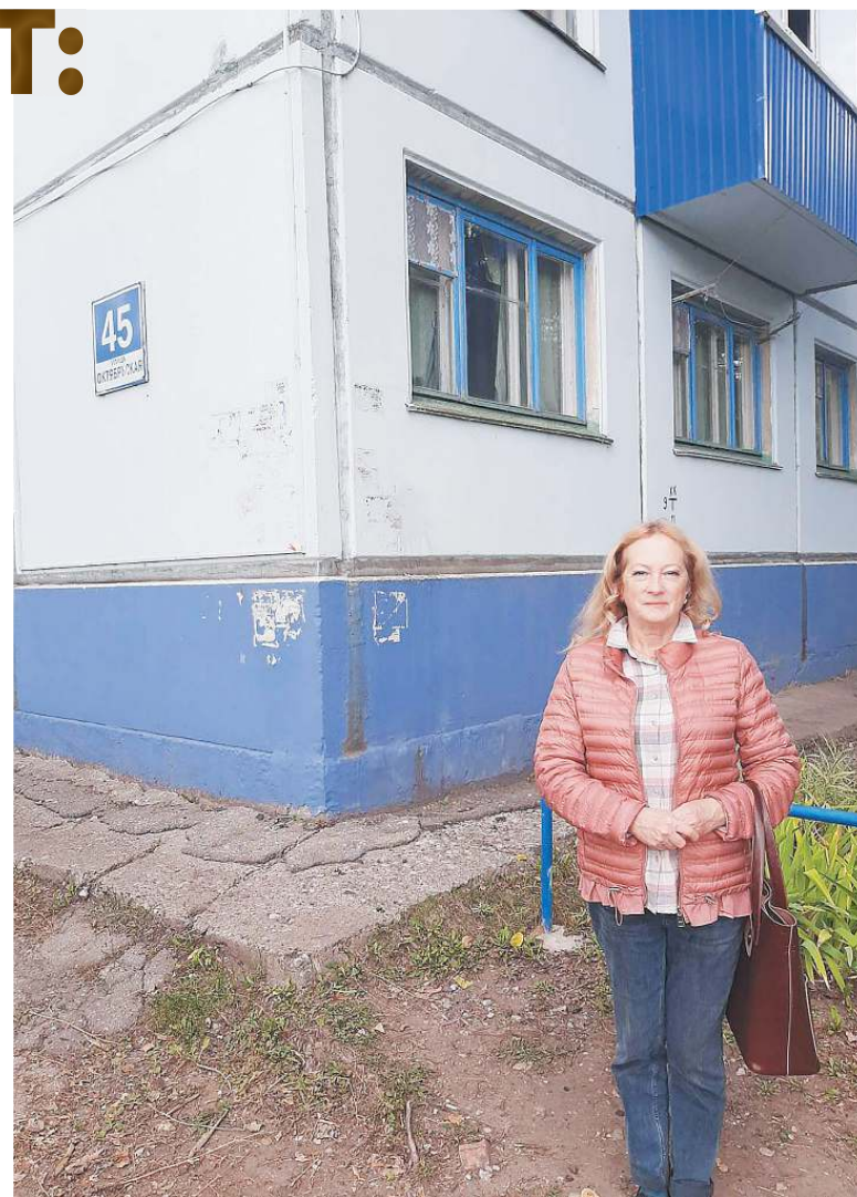
Евгения ЗАХАРКИНА встала на защиту своего дома и сопротивляется давлению, отказываясь подписывать акты выполненных работ, низкое качество которых не устраивает жильцов
