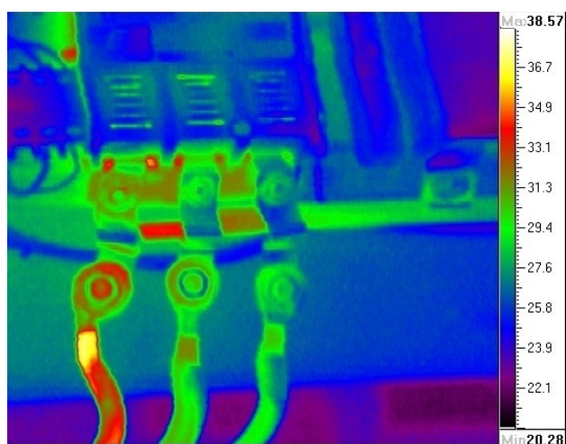
Рисунок 21. Пример термограммы контактных соединений с температурной шкалой
