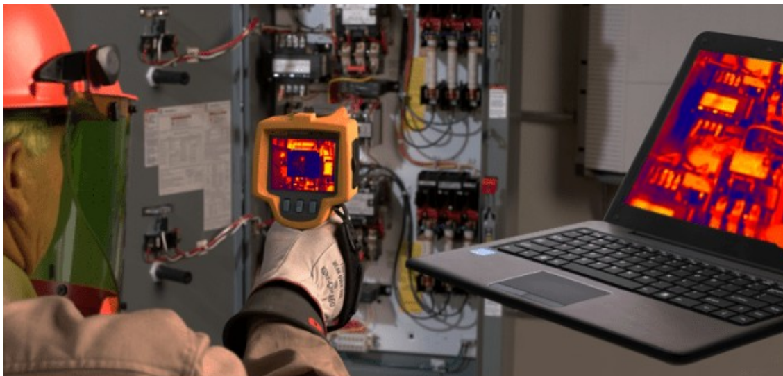
Рисунок 20. Пример проведения тепловизионного контроля электрошкафа
