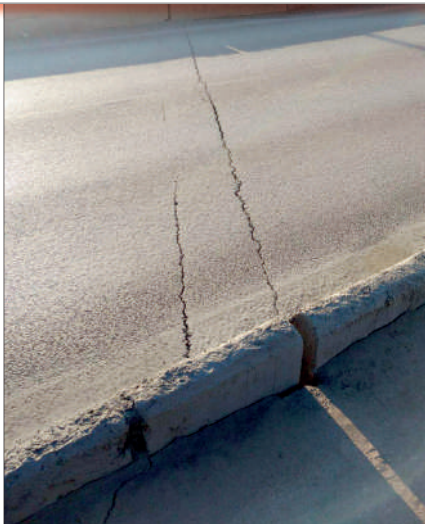
Еще в начале января жители сообщили в соцсетях, что появились трещины на мосту через Свиягу по ул. Минаева
