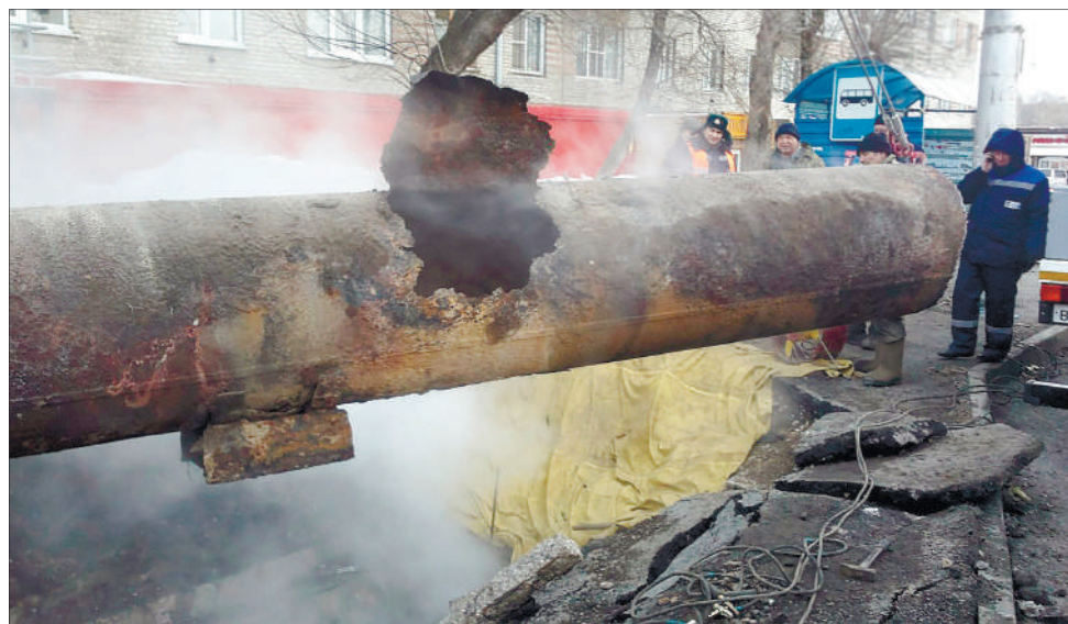
Износ тепловых сетей в Ульяновске (по официальным данным) составляет 62%, или 700 км трубопроводов, которые имеют срок службы более 20 лет
